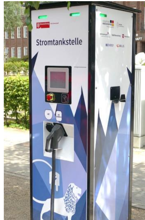
Abbildung 2: Ladesäule für Elektromobilität
