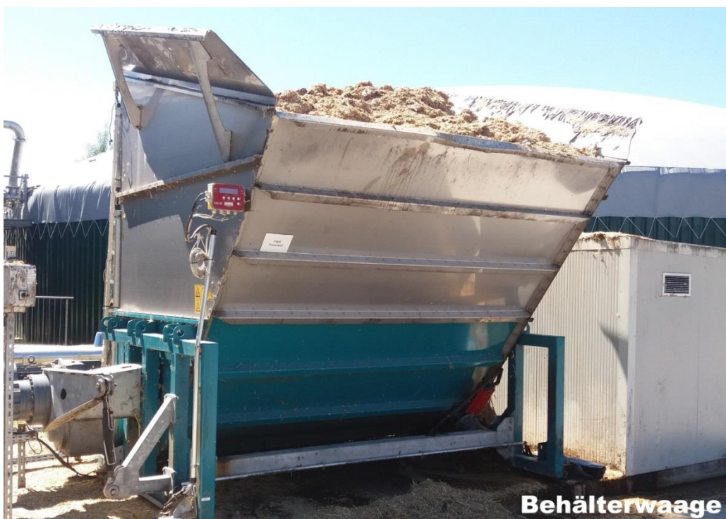
Abbildung 4: Behälterwaage in Biogasanlage
