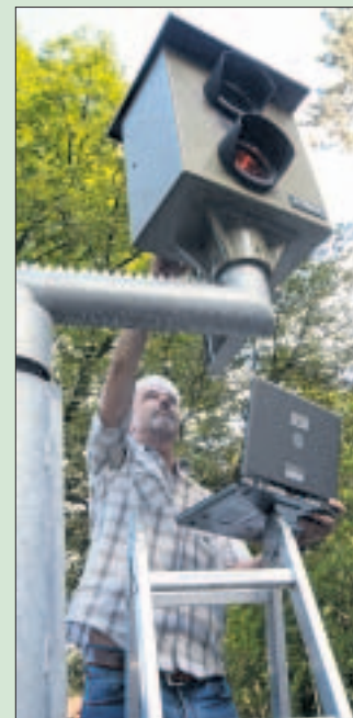
Damit nur auf Raser „geschossen“ wird: Holger Leibelt liest Daten aus dem „Starenkasten“ auf der Crimmitschauer Straße in Zwickau in seinen Laptop ein.
